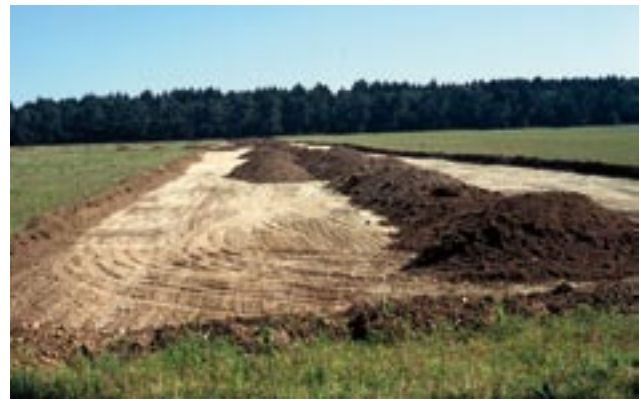
Abbildung 2: Die bis auf den anstehenden Kies freigeschobenen Gassen zwischen den ehemaligen Äckern und Oberboden von der Panzerwiese zur Verteilung auf der Fläche.
